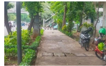
Gambar 25 Penutup Drainase Jalur Pedestrian Jalan Kyai Tapa (Sumber : data pribadi)
