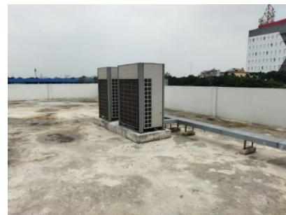
Gambar 12. Outdoor AC Central (Sumber: Dokumentasi Pribadi, 2024)
