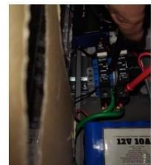
Gambar IV.2 Pengukuran Solar Panel
