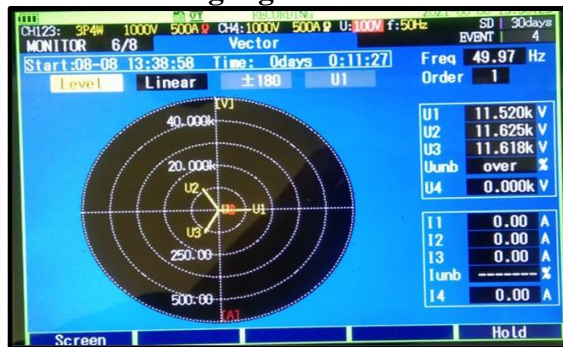
Gambar 3.1 Hasil Pengukuran Phase Rotation Pada Panel Incoming 20 kV Pengukuran phase rotation di panel incoming 20 kV gardu utama pelanggan
