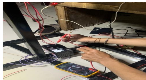
Gambar 14. Pengujian Discharging Baterai
