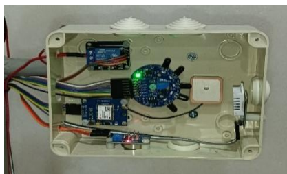
Gambar 5. Perangkat Pembangkit Listrik Energi Surya
