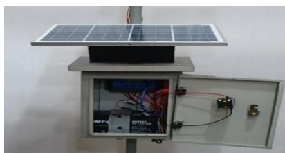
Gambar 4. Perangkat Pembangkit Listrik Energi Surya
