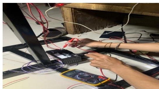
Gambar 14. Pengujian Discharging Baterai
